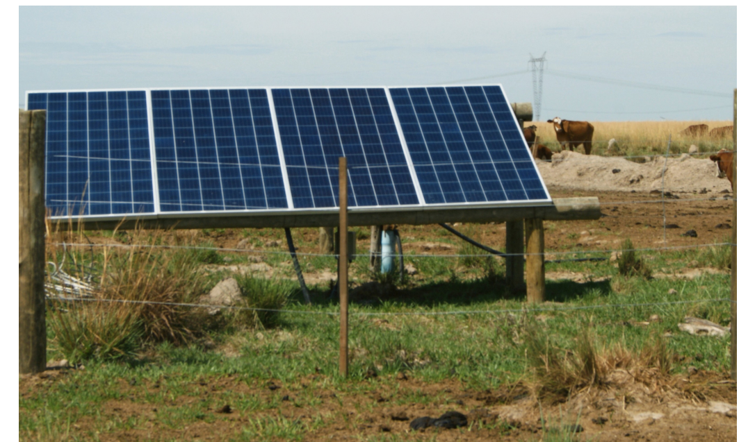
Paneles solares como fuente de energía.
